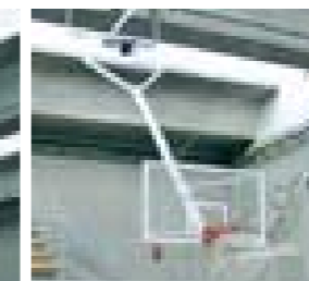
CANASTAS MONOTUBO FIJADAS AL TECHO
