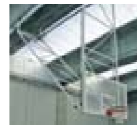
CANASTAS MULTITUBO FIJADAS AL TECHO
